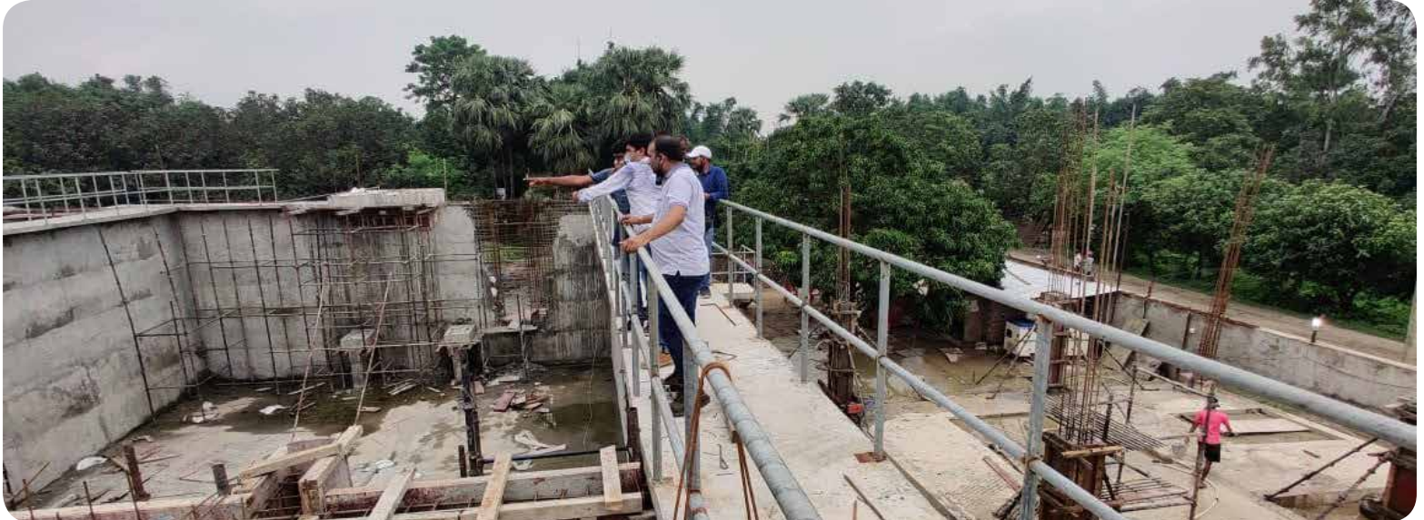
Rajmahal- 3.5MLD STP
