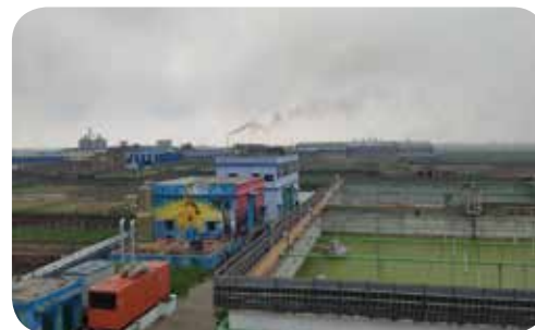
Karmalichak STP - 37 MLD
